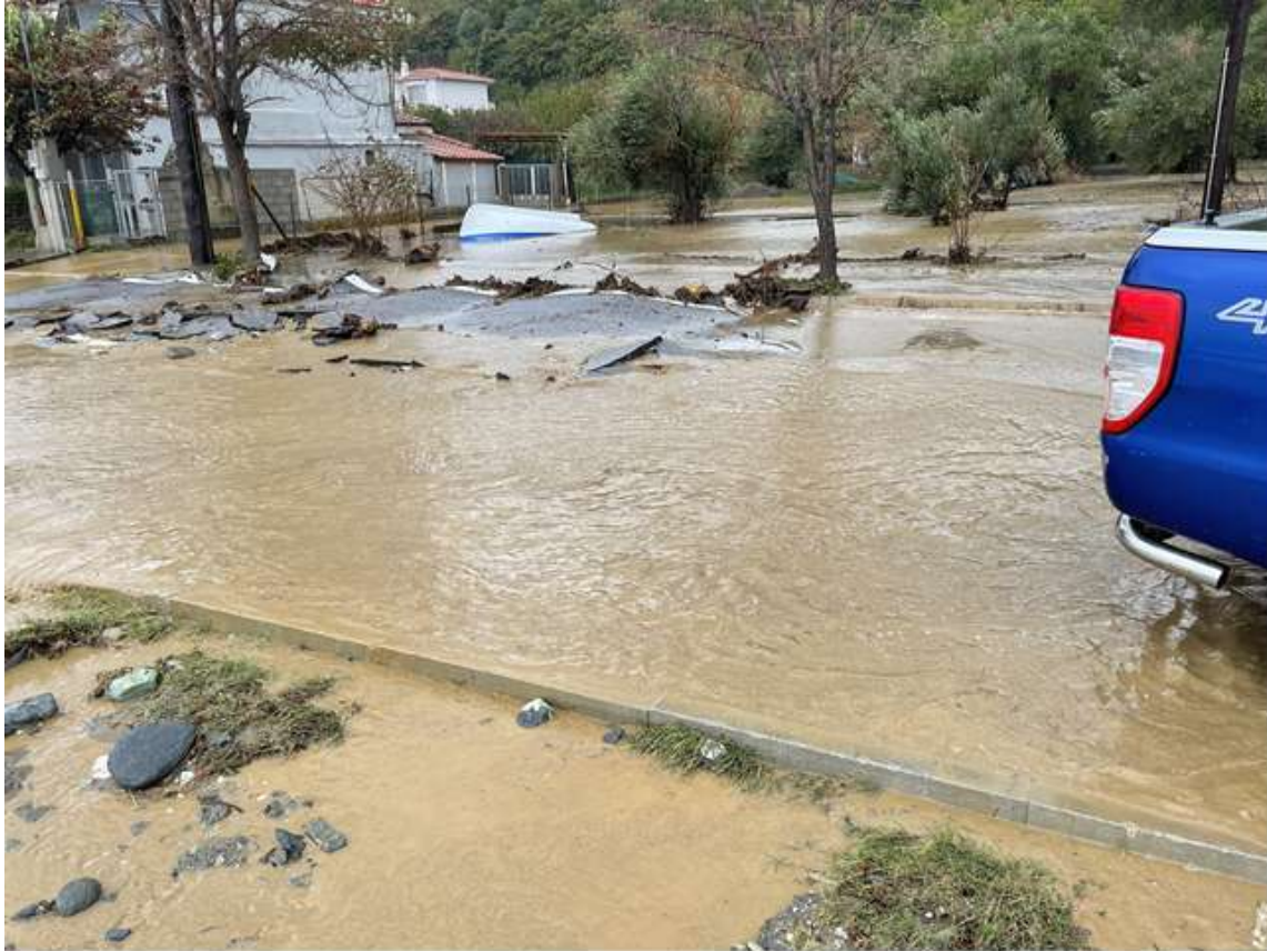
Εικόνα 1.2: Υφιστάμενη δημοτική οδό μετά από τις πλημμύρες.
