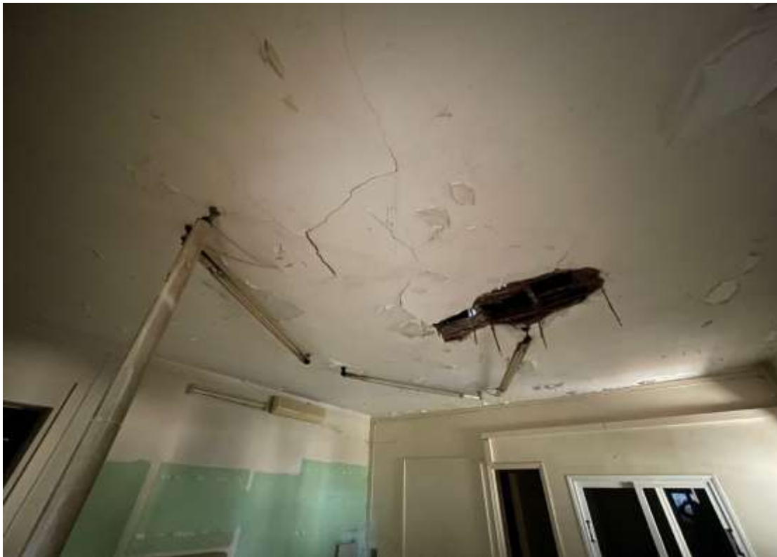
Εικόνα 1.3: Ζημιές σε δημοτικά κτίρια μετά από τις πλημμύρες.
