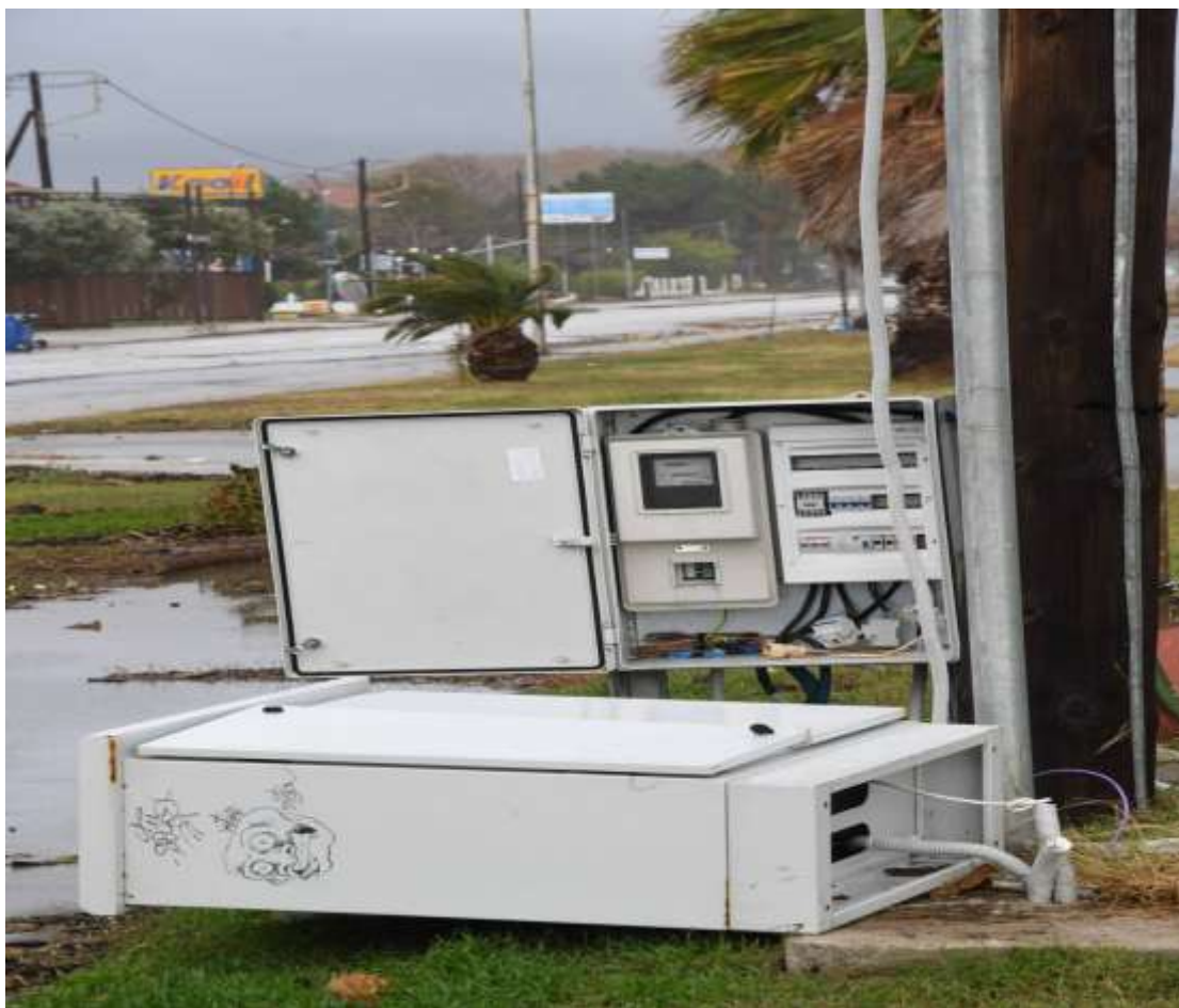
Εικόνα 1.4: Ζημιές στον δημοτικό φωτισμό και Η/Μ εξοπλισμό.
