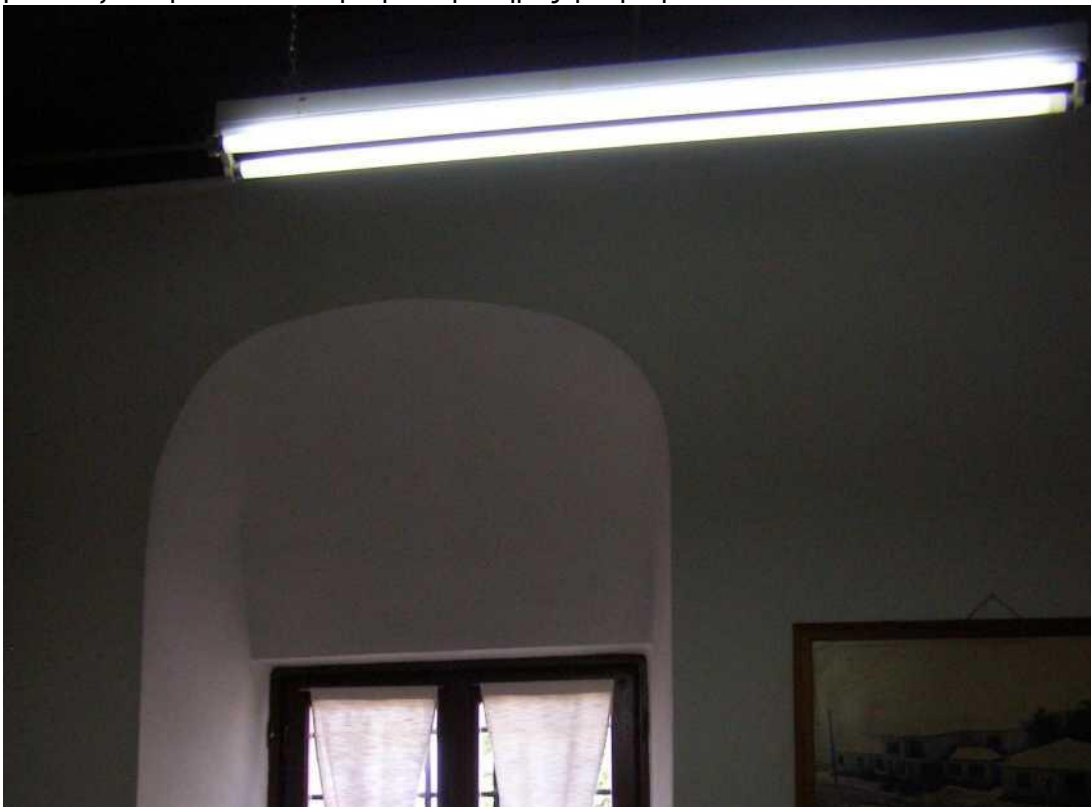
Εικόνα 11: Εγκατεστημένο φωτιστικό σώμα φθορισμού
