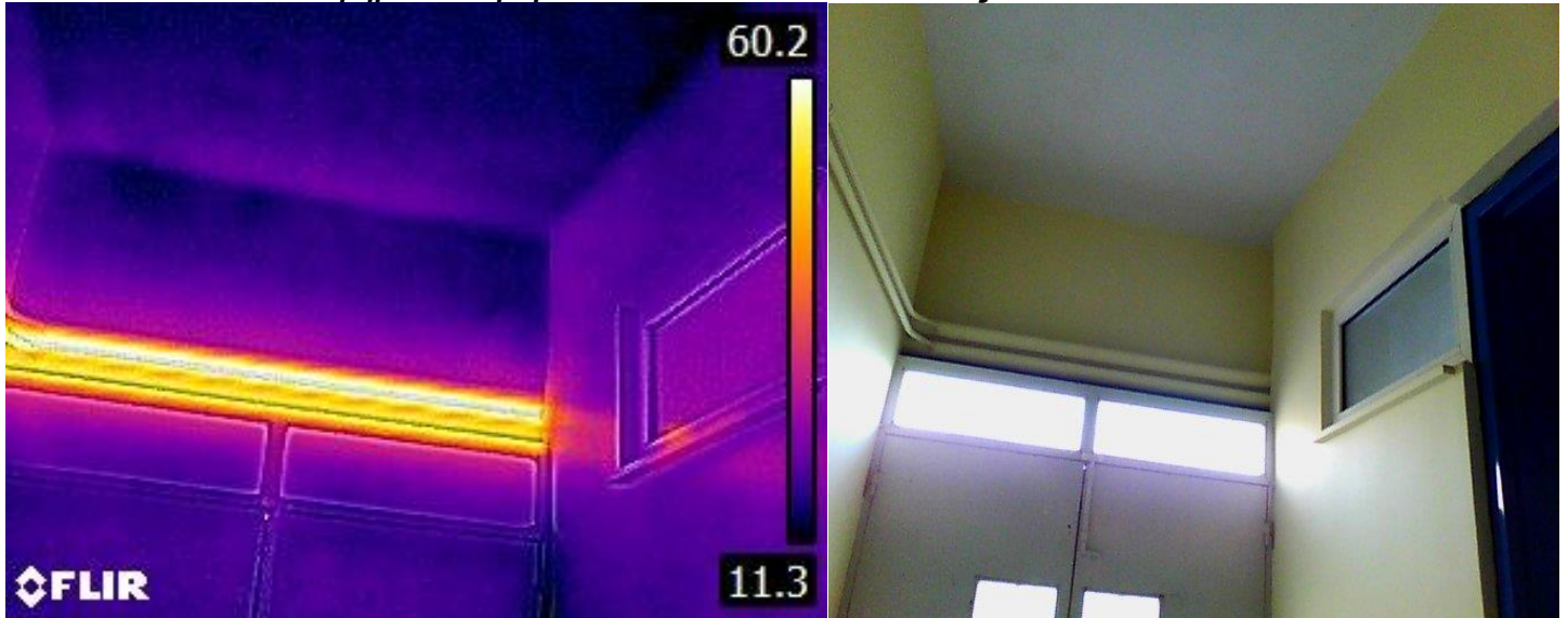
Εικόνα 7 : Θερμογράφιση Δομικών Στοιχείων
