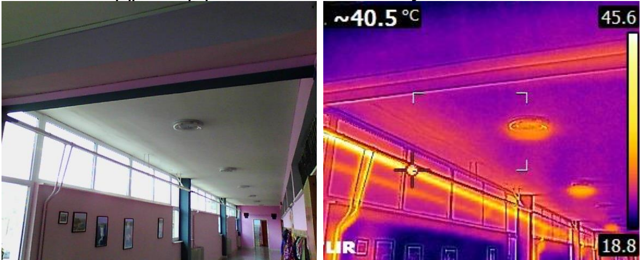
Εικόνα 6: Αποτύπωση θερμογεφυρών και σημεία συγκέντρωσης υγρασίας
