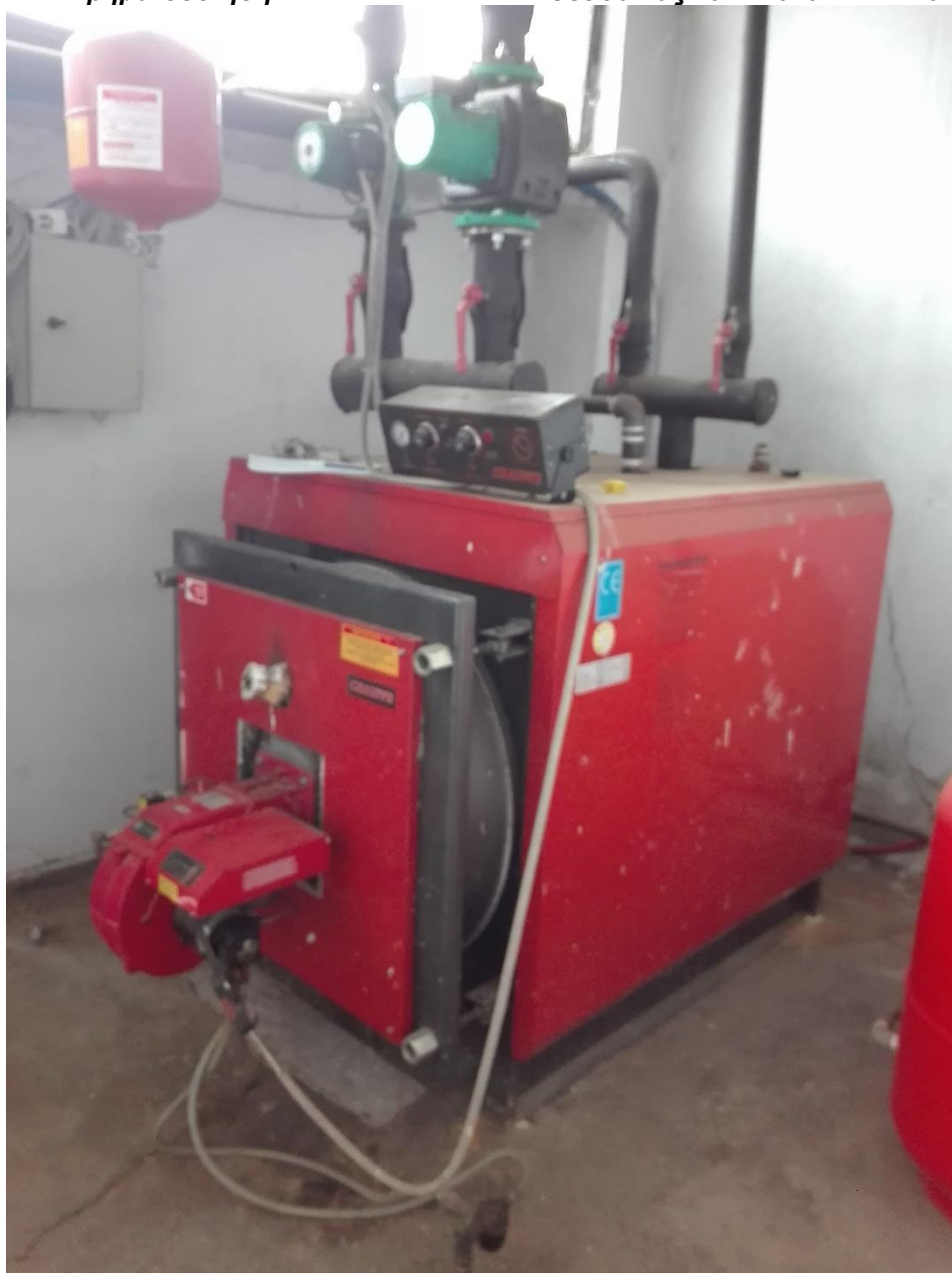
Εικόνα 9: Μονάδα Λέβητα - Καυστήρα
